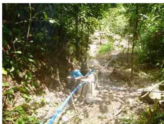
ランポンプに供給する湧水をためるタンク
